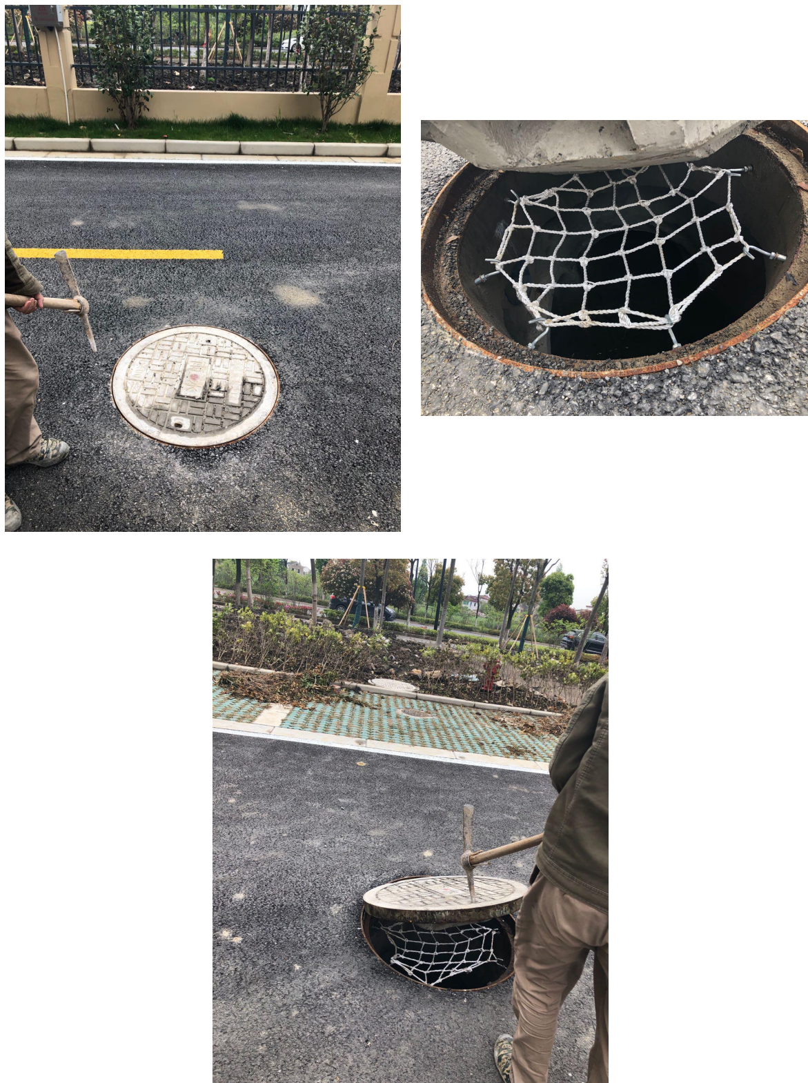
图 3-1 项目雨水排口照片
