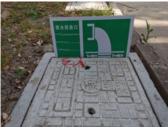
图 3-1 雨水排口及标识牌
