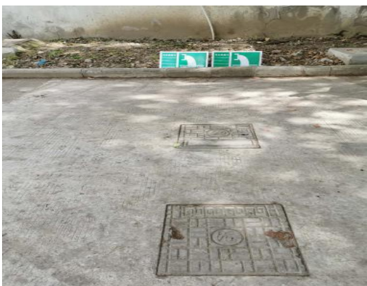
图 3-2 生活污水排口及标识牌
