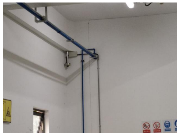
危险废物内部视频监控
