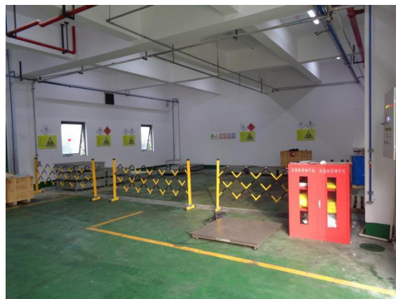
危险废物仓库收集措施
