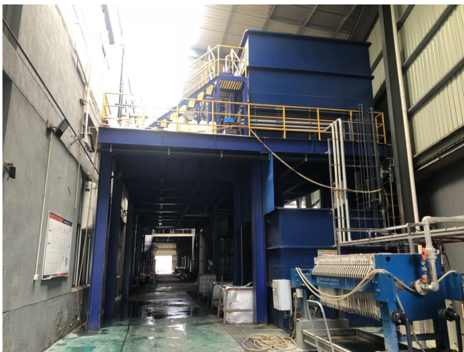
图 4-11 污水处理站整体情况
