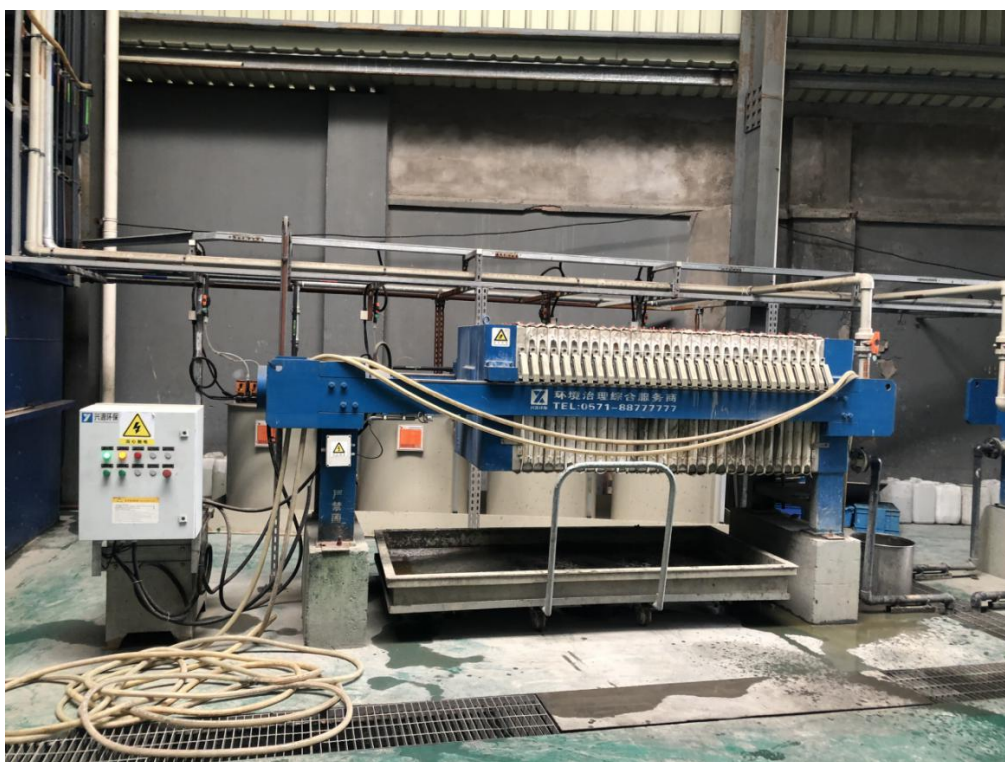
图 4-13 污水处理站压滤机
