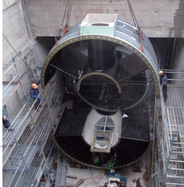
新川河口排水泵站 / 新潟县
