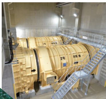
栗子隧道通风设备 / 东北中央自动车道
