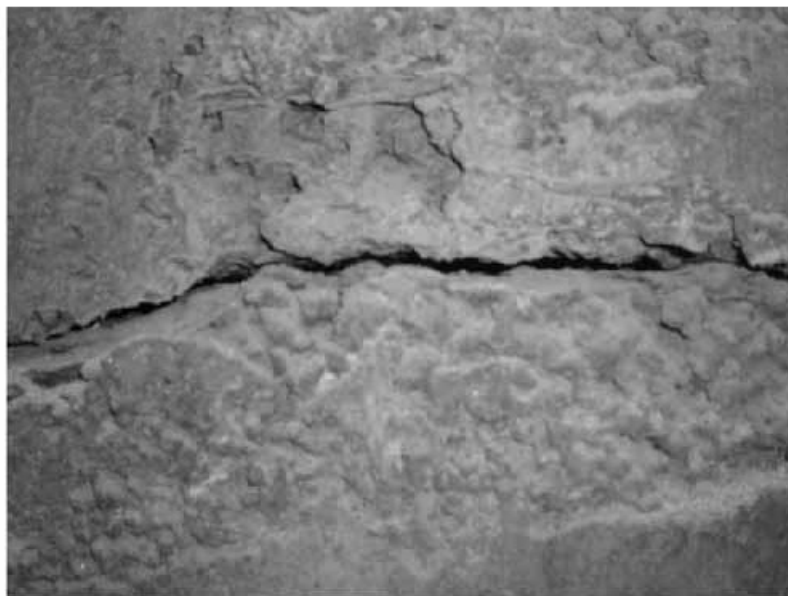
(图2：积灰平台处胶泥裂缝图片)
