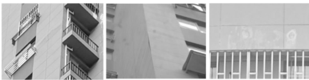
图11 上海某小区外墙出现空鼓、阳角开裂及渗漏等质量问题
