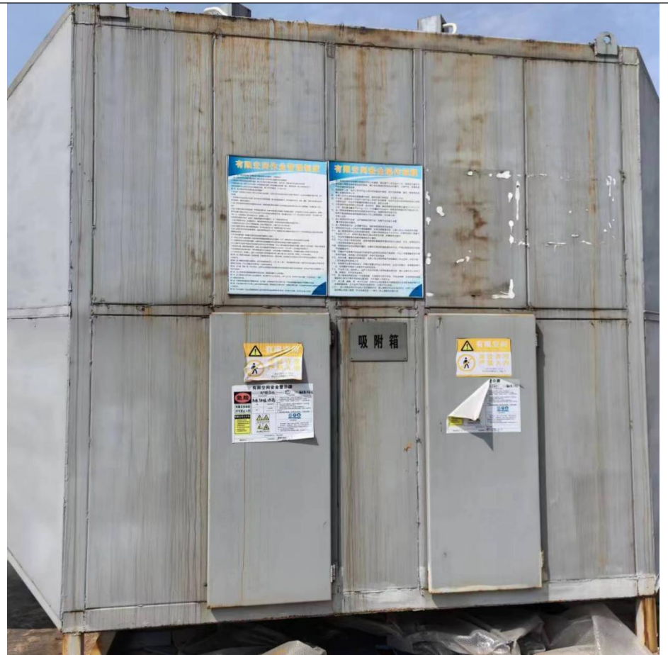
沸石吸附箱（原一期建设）
