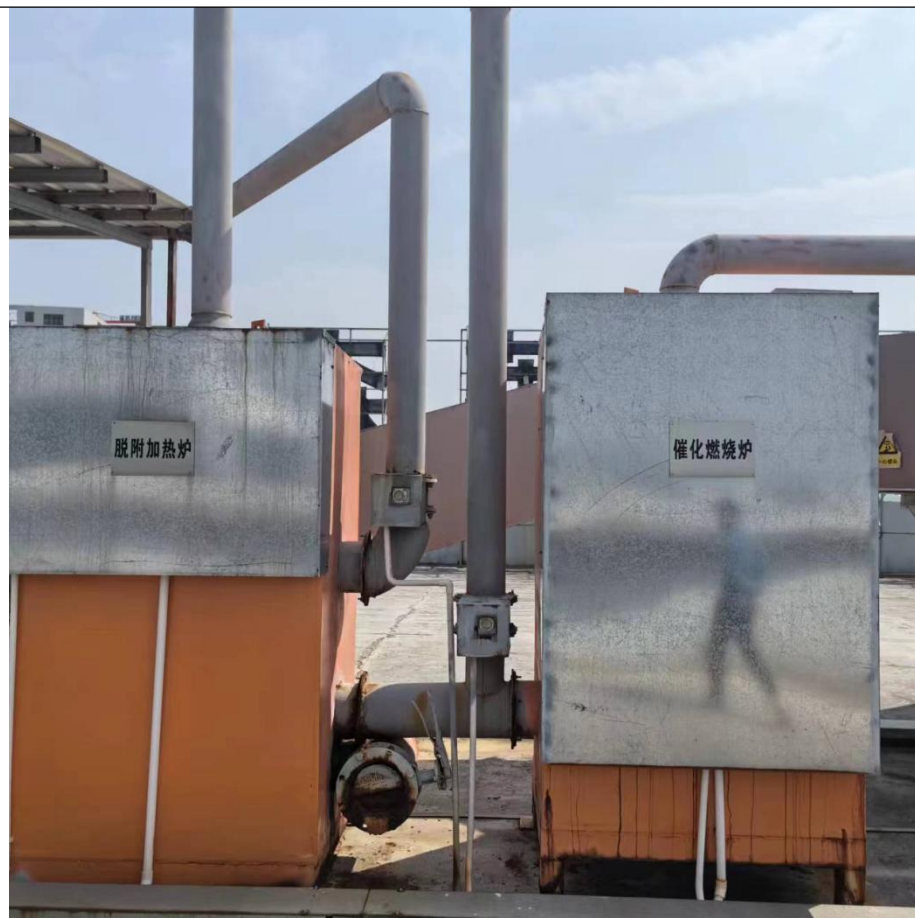
催化燃烧设备（原一期建设）
