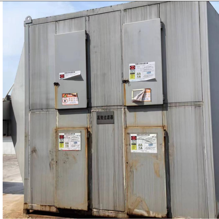
高效过滤器（原一期建设）
