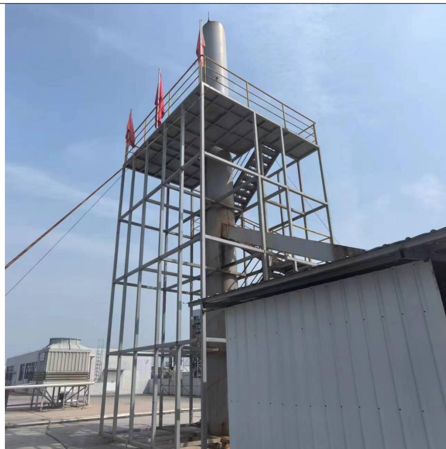
DA001 废气排放口（原一期建设）
